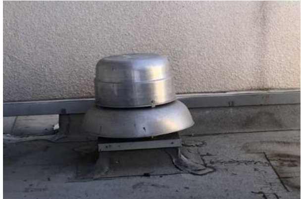
#38 ROOF TOP EXHAUST FAN
