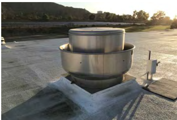
#35 ROOFTOP EXHAUST FAN
