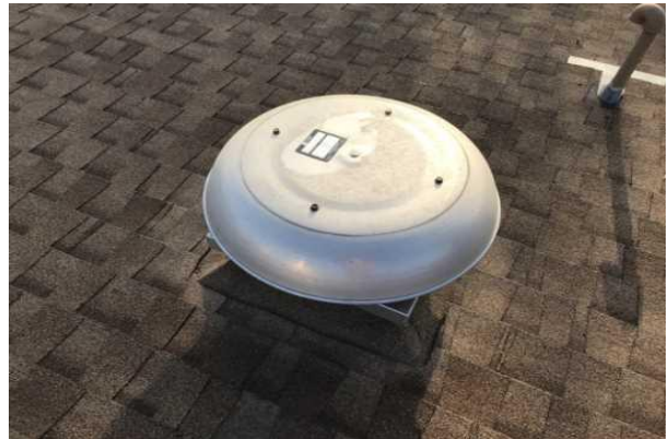
#28 ROOFTOP EXHAUST FAN
