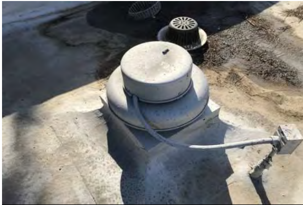
#25 ROOFTOP EXHAUST FAN
