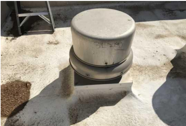
#27 ROOFTOP EXHAUST FAN
