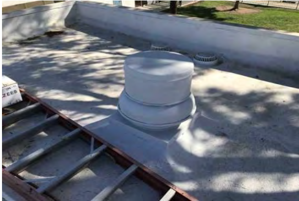
#31 ROOFTOP EXHAUST FAN
